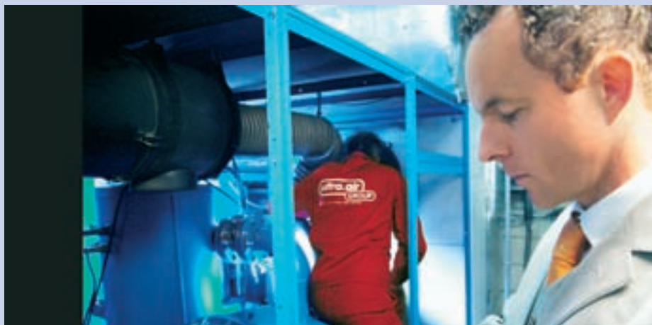
Qualifiziertes Service-Personal stellt – in Verbindung mit dem Telemonitoring – die Verfügbarkeit der Druckluftstation sicher
