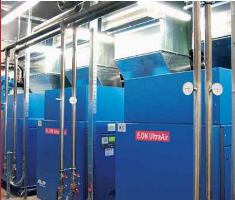
E.ON UltraAir plante für die erste Ausbaustufe eine Druckluftstation mit vier 132 kW-Schraubenkompressoren und einer drehzahl-geregelten 210 kW-Maschine, die die Spitzenlast übernimmt
