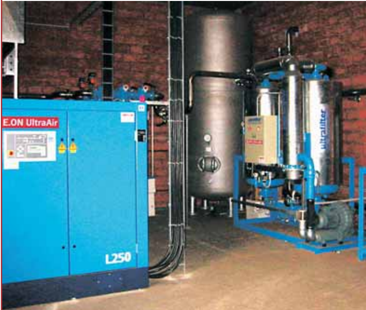
Die Druckluftstation für die Ford-Lackierstraße in Genk liefert Druckluft, die 100.000 mal reiner ist als Umgebungsluft.
