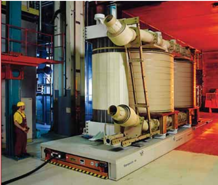
Die Luftkissenfahrzeuge, mit der die bis zu 600 Tonnen schweren Trafos bewegt werden, nutzen die Druckluft der erweiterten Kompressorstation als Antriebsenergie.
